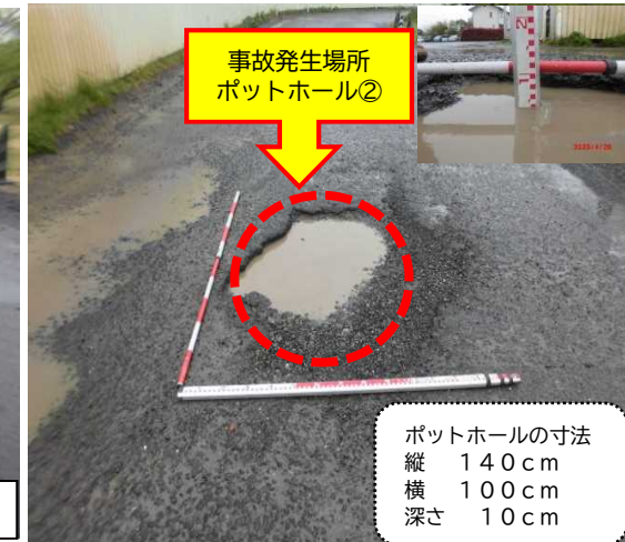
▼事故発生場所(ポットホール②拡大)
