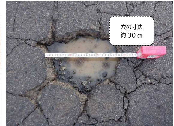
▼事故発生場所(ポットホール拡大)
