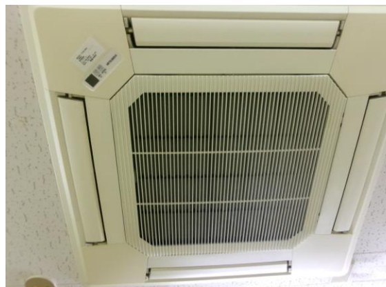
天井カセット型エアコン（取替前）
