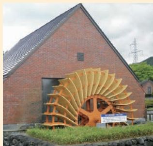
▲四季の里小水力発電設備
