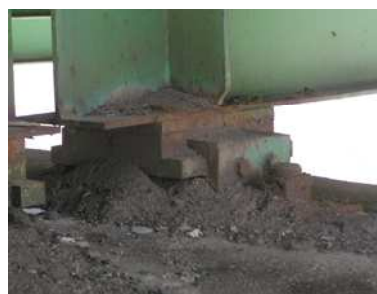
支承部の土砂堆積
