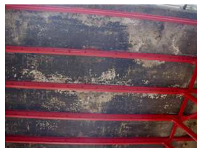
コンクリート床版の漏水・遊離石灰
