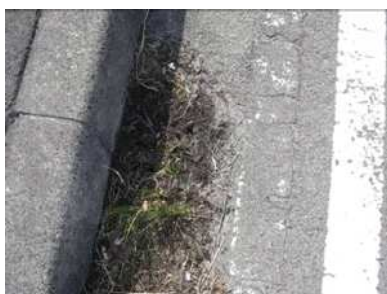
排水ますの土砂詰まり
