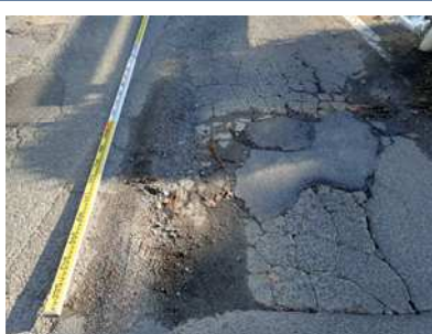
舗装のひびわれ・ポットホール
