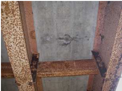
鋼主桁の腐食
