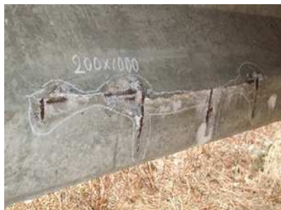
コンクリート主桁の剥離・鉄筋露出
