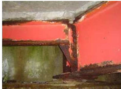
鋼主桁端部の腐食
