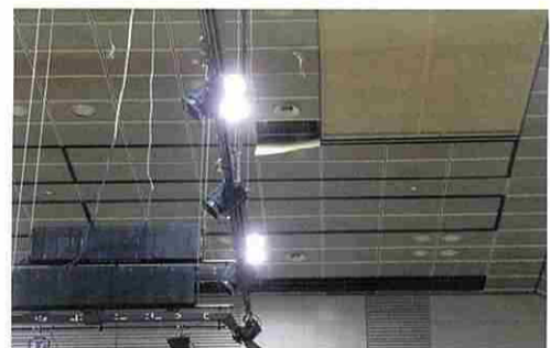
地震で天井に被害があった国体記念体育館
