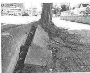
根上がりによる盛り上がった歩道
