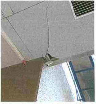
地震の被害があった児童福祉施設
