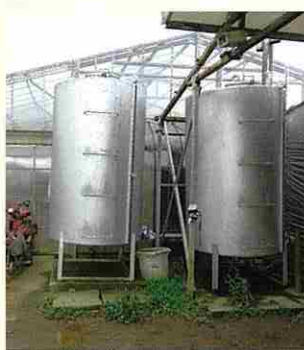
大型ハウスの重油タンク
