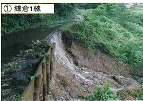
大雨で被害のあった林道
