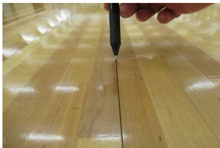
①すき間発生状況(剣道場全体に発生)
