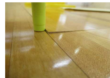
③箇所床材の反り
