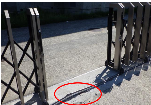
門扉レール破損状況
