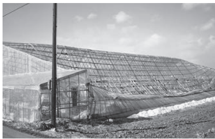
大雪による被害状況
