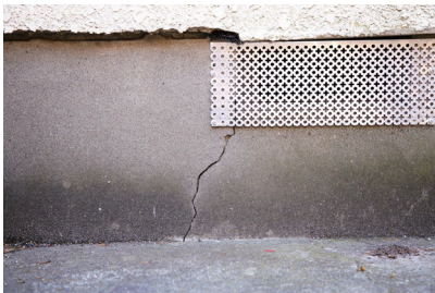
換気口付近のひび割れ
