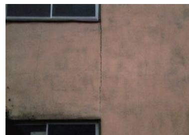
外壁のひび割れ
