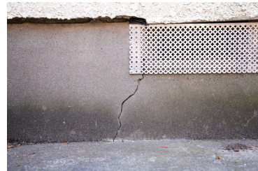
基礎のひび割れ
