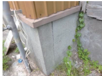
基礎のひび割れ
