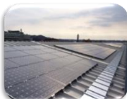
軽量型太陽光パネル （新幹線ホーム屋上）
