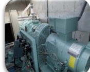
水道供給施設を活用した小水力発電
