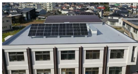
三河台学習センターの太陽光発電設備
