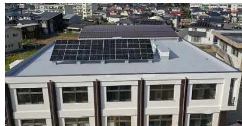
三河台学習センターの太陽光発電設備
