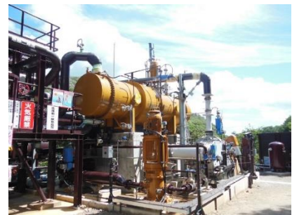
土湯温泉バイナリー発電所
