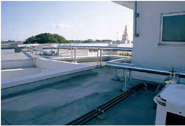
写真-6.10.1.10 プールへ給水するための屋上配管
