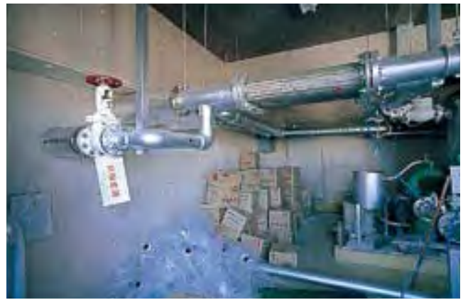
写真-6.10.1.11 プールからトイレへの切替バルブ
