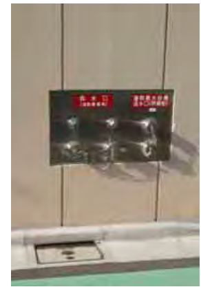
写真-6.10.1.6 屋上プールの水を消火に使用できる消防用採水口
