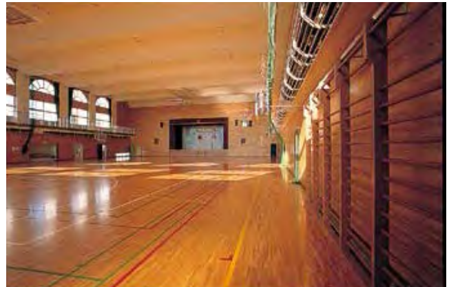
写真-6.10.1.12 キャットウォーク下部の遠赤外線ヒーター
