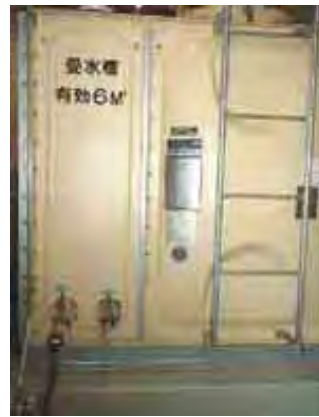
写真-6.10.1.5 水を取り出せる水栓を備えた受水槽
