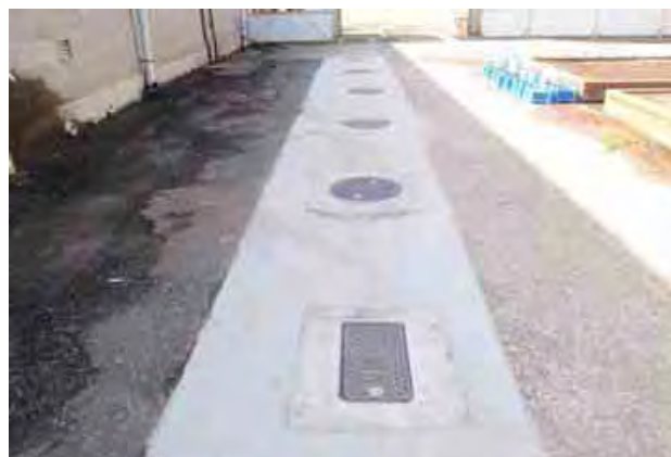
写真-6.10.1.7 非常時にトイレとして使用できるマンホールトイレ（東京都目黒区）
