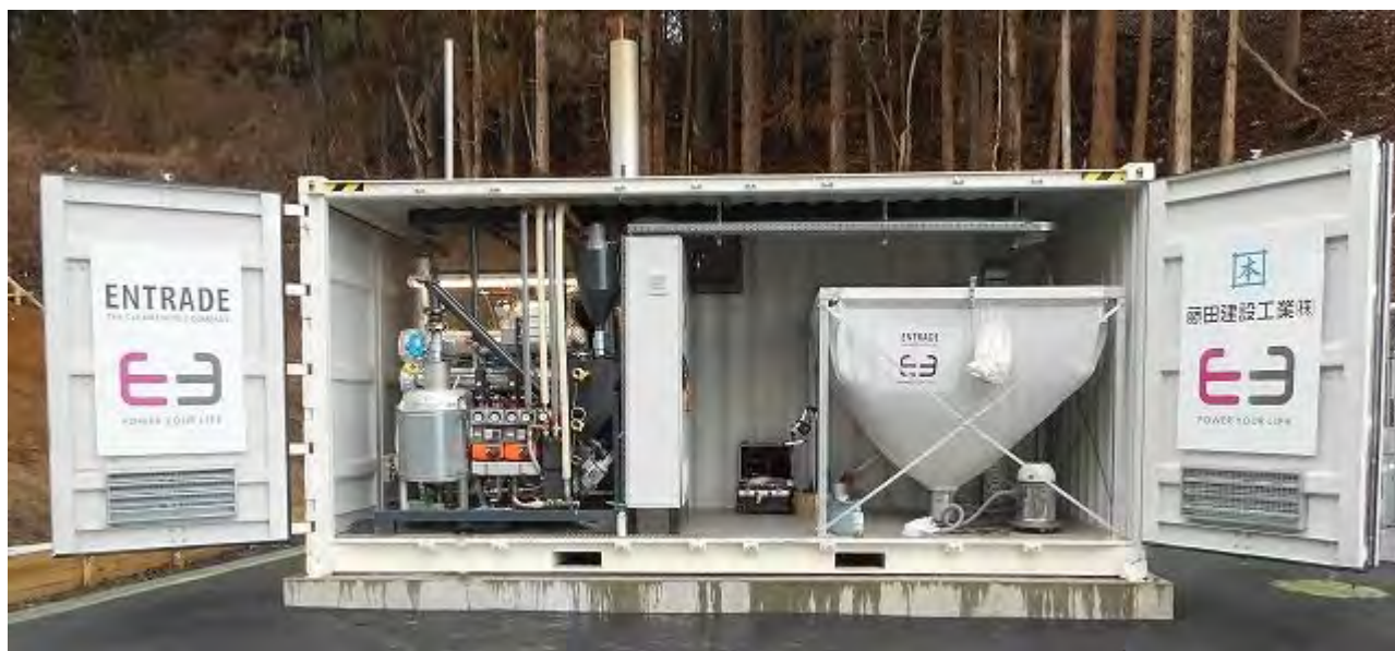
図-7.2.1 スパ・ホテルあぶくまの小型木質バイオマス熱電併給プラント (藤田建設工業ホームページより)
