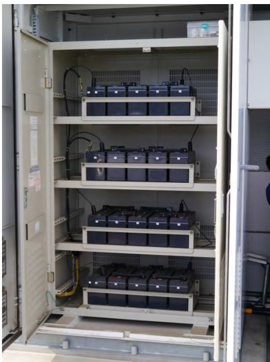
写真-1.2.2.3 仙台南営業所の蓄電池
