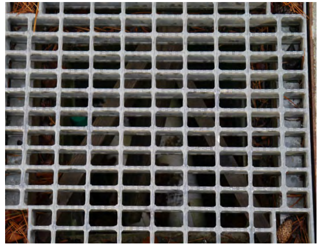
写真-1.2.4.2 NICHe 近郊の地中熱交換部(2)
