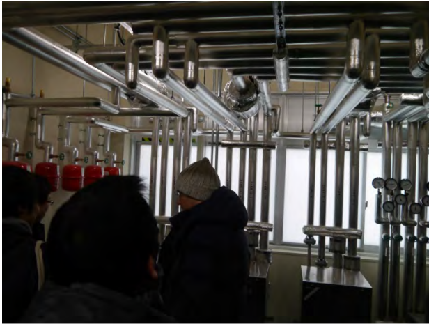
写真-1.8.1 ヒートポンプ見学の様子
