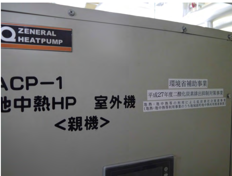
写真-1.6.3 ヒートポンプ設備
