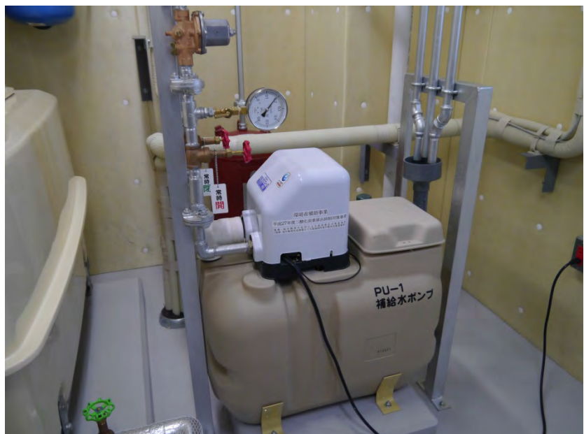
写真-1.6.4 補給水ポンプ
