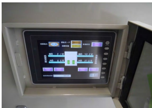
写真-1.2.3.3 カタール内のヒートポンプモニター(1)
