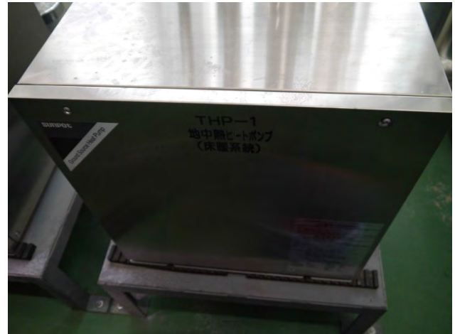
写真-1.8.2 ヒートポンプ設備
