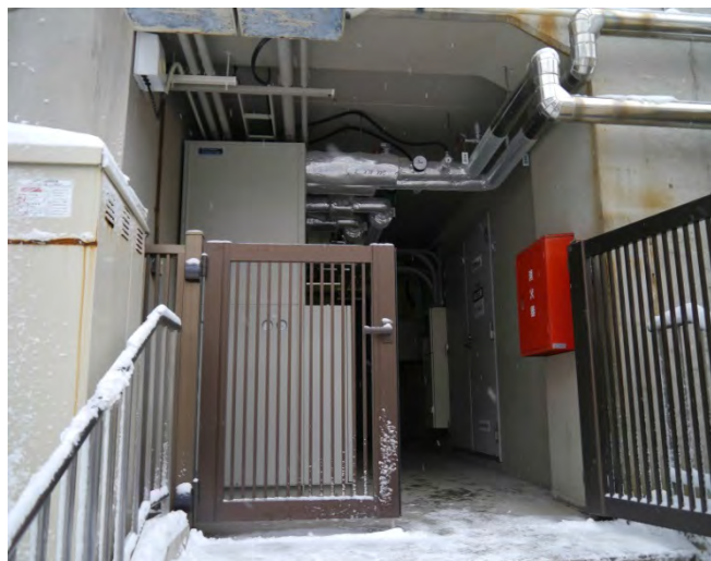
写真-1.3.2 ヒートポンプ設備外観
