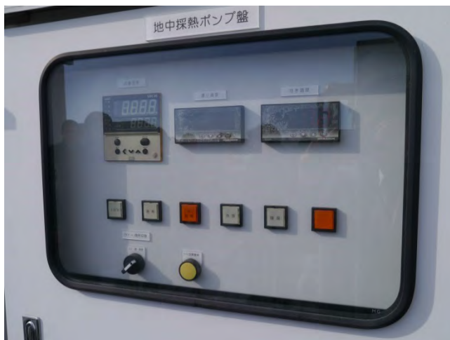
写真-1.2.2.4 仙台南営業所の地中熱採熱ポンプ盤
