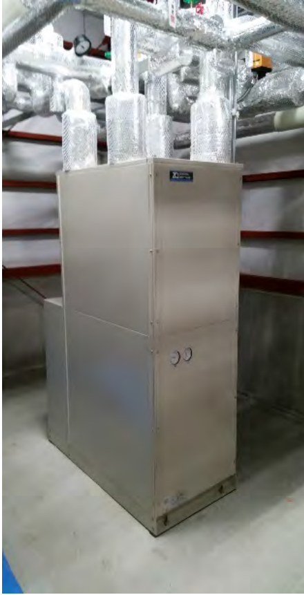
写真-2.4.3 加温、冷却用ヒートポンプ
