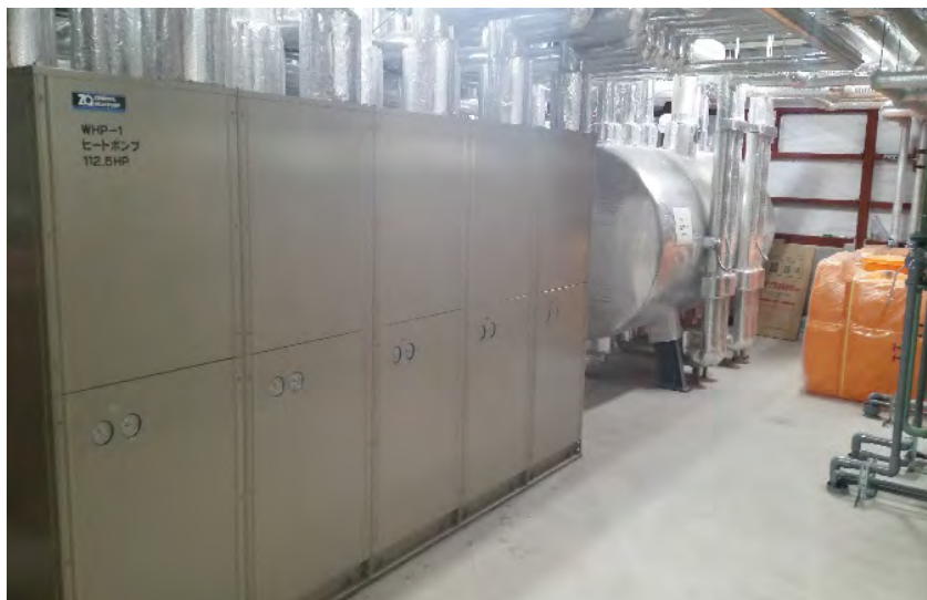
写真-2.4.2 冷暖房用ヒートポンプ
