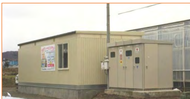
写真-2.3.3 ヒートポンプ機械室
