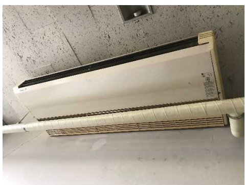
堀河町終末処理場管理棟 2 階 旧操作室エアコン
