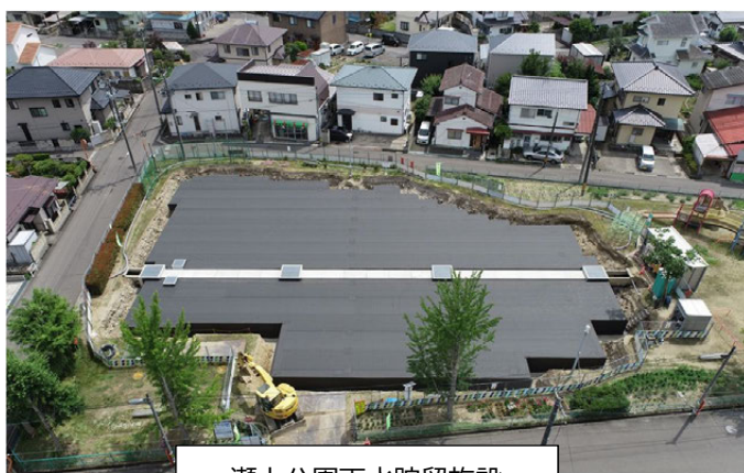
瀬上公園雨水貯留施設
