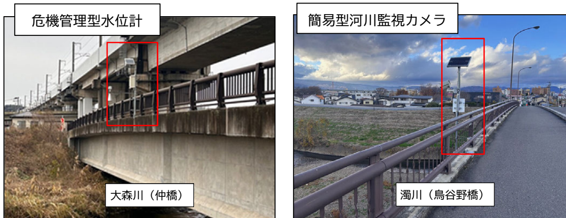
図 4-19 危機管理型水位計、簡易型河川監視カメラの設置状況
