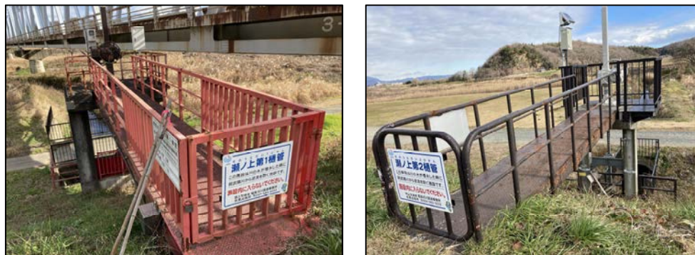
図 6-8 市内に設置している樋管
