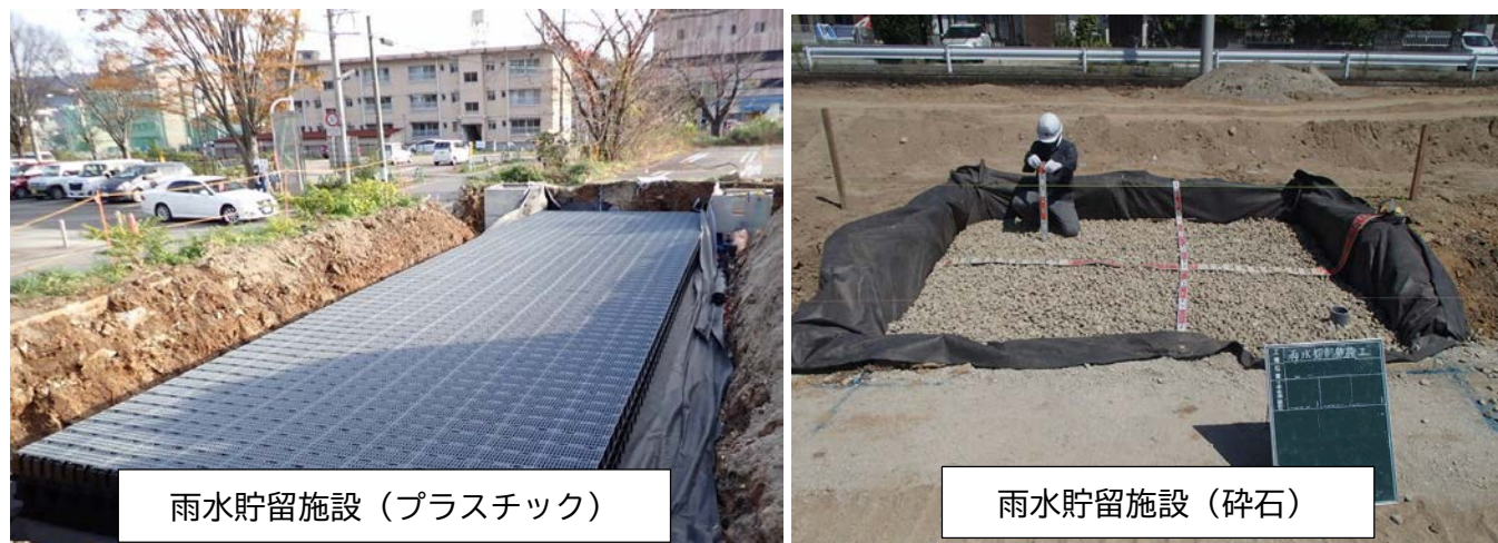
図 4-57 民間雨水貯留施設設置のようす
