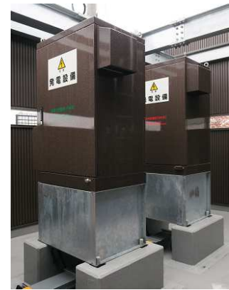
非常用発電機
