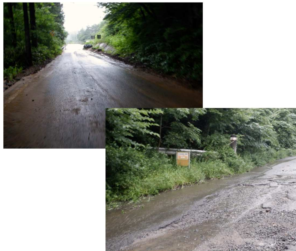
豪雨により大量の泥水が流れ込み、道路の路面に土砂が流出
