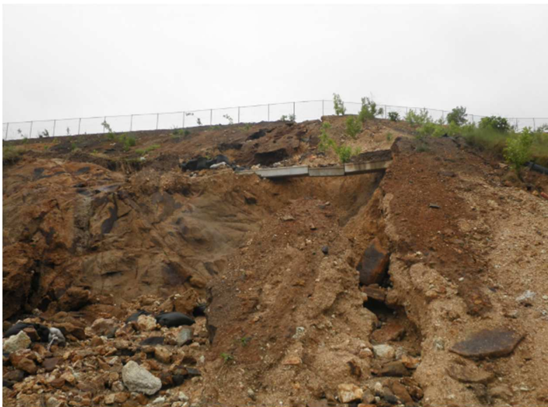
大規模太陽光発電施設の法面崩落による土砂流出
