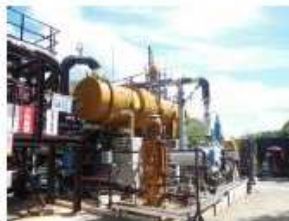
土湯温泉バイナリー発電所
