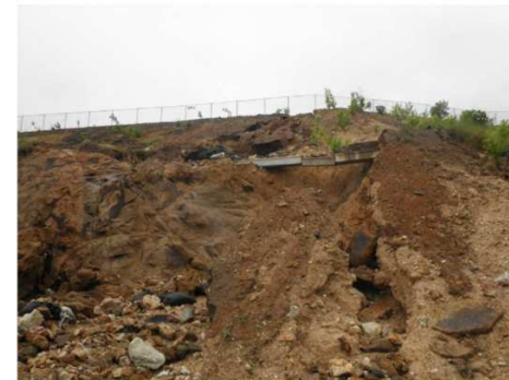
法面崩落による土砂流出の状況
