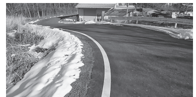
10 市道佐久間・西原山線 道路改良(舗装)工事(下川崎字西原山地内)
