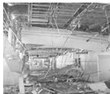
▲平成23年の東日本大震災時の被害状況(5階スタンド席)
