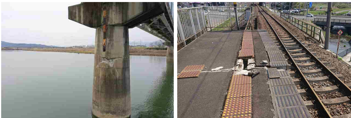
図 福島県沖地震による阿武隈急行線の被害状況
