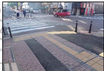
地面と点字ブロックの明度差が小さい
