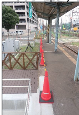
ホームに柵が無くて危険
