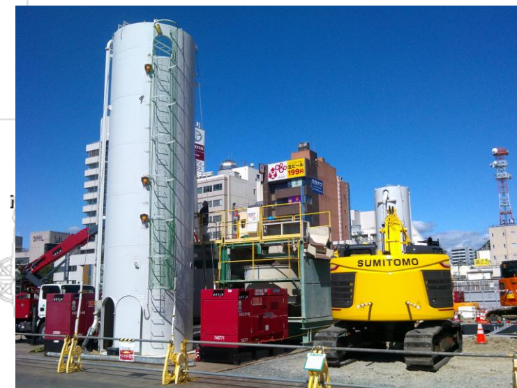
プラント施設
