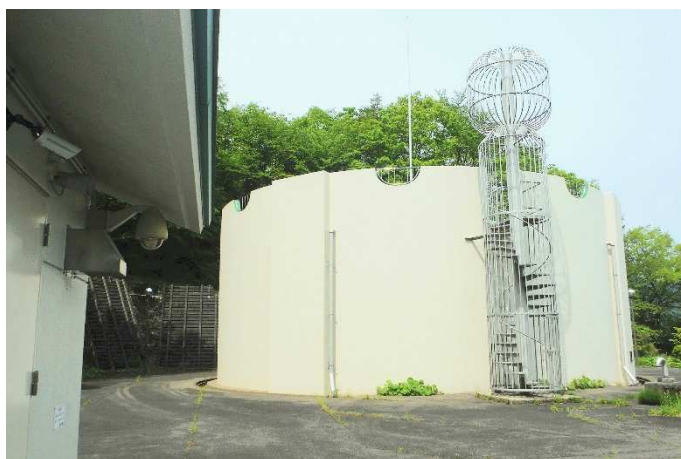
【金剛山配水池】
