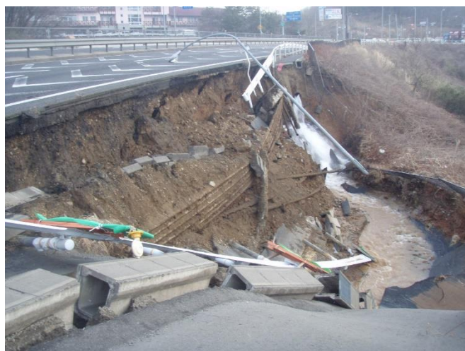
【東日本大震災/国道4号崩落箇所】
