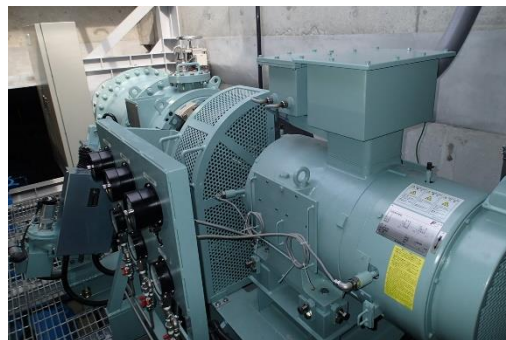
【北部配水池小水力発電】
