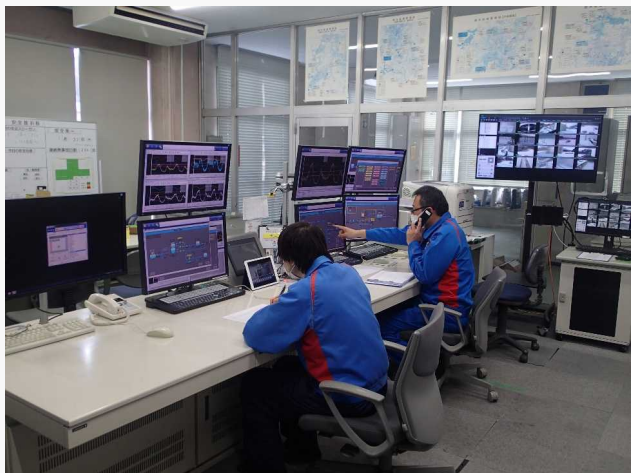
水道施設管理センター中央監視室
