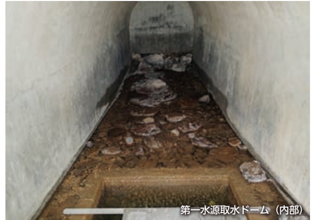
第一水源取水ドーム
