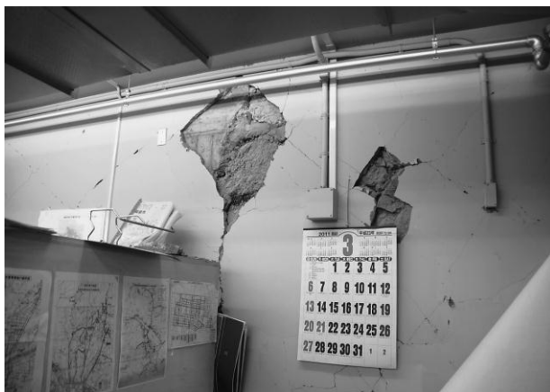
福島市水道局の被災状況
