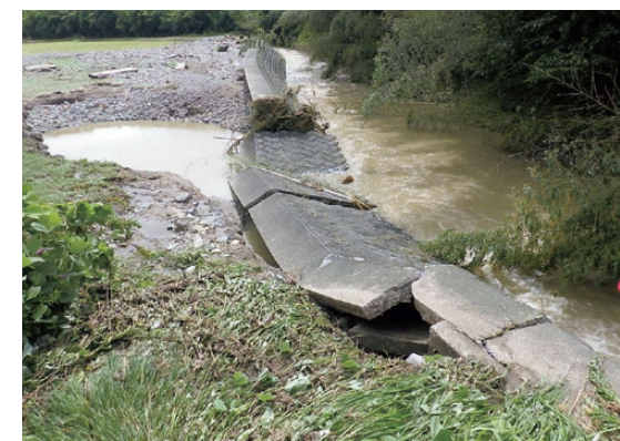
▲護岸が崩落した藤原川(いわき市)
