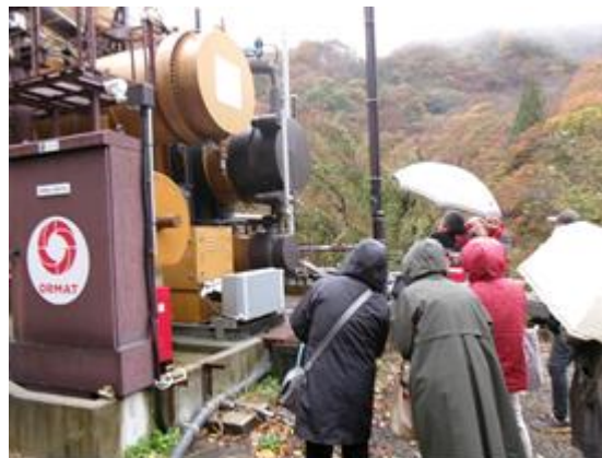
第7回消費生活学習会 (土湯温泉バイナリー発電所)
