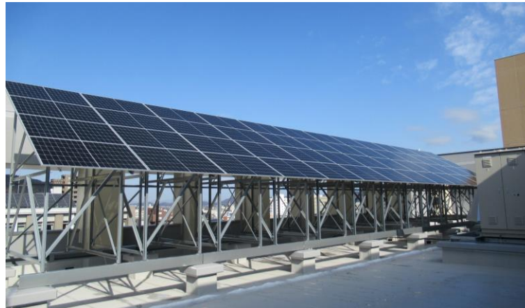
▲太陽光発電設備
