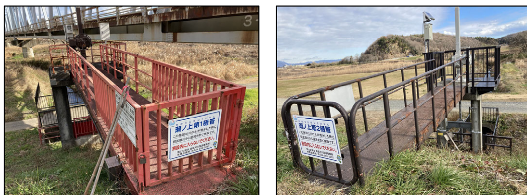
図 6-8 市内に設置している樋管
