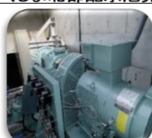
2. ふくしま北部配水池発電所
