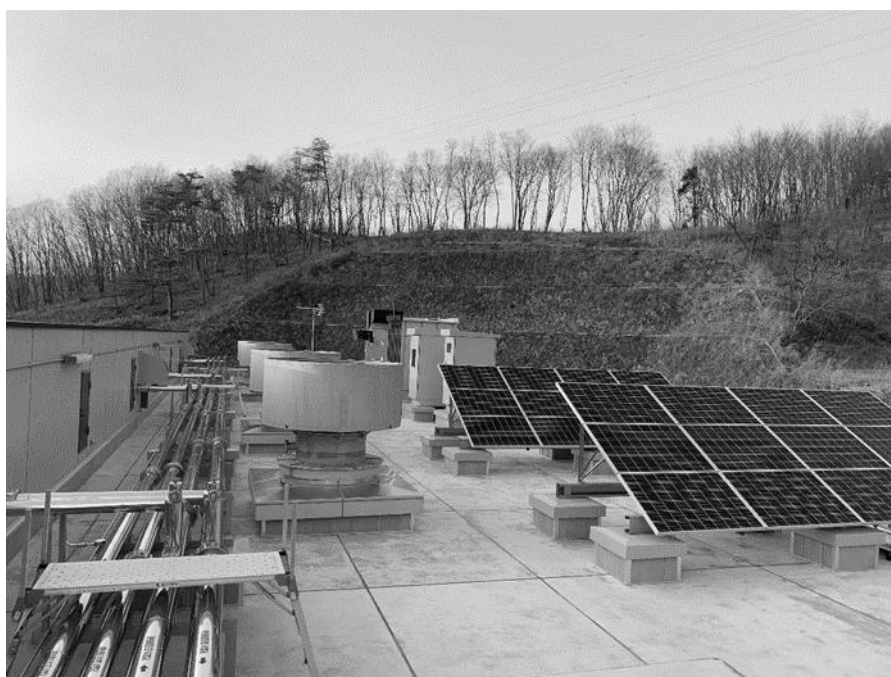
公共施設への太陽光発電設備導入（福島市斎場）
