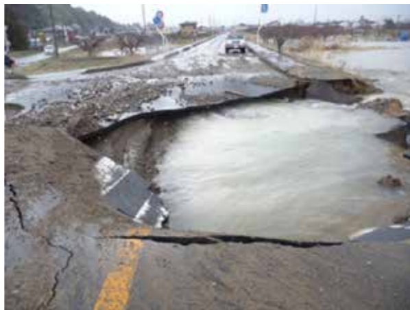
飯坂町中野地内の送水管破損に伴う漏水
