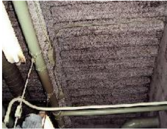
石綿含有吹付けロックウール
