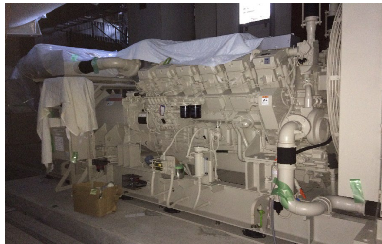
非常用発電機
