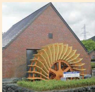
▲四季の里小水力発電設備
