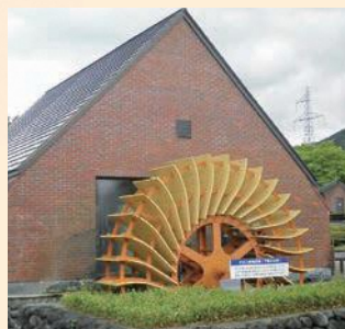
▲四季の里小水力発電設備
