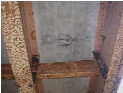
鋼主桁の腐食
