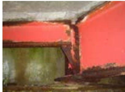
鋼主桁端部の腐食
