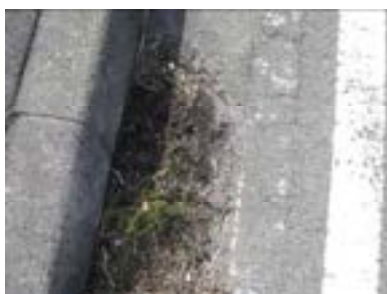
排水ますの土砂詰まり
