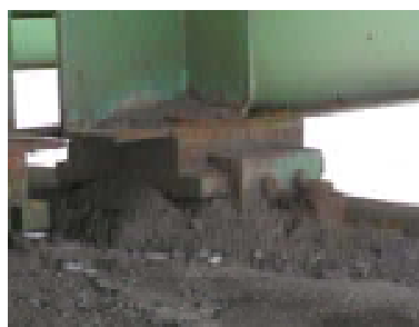
支承部の土砂堆積
