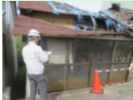
【空き家特措法に基づく現地調査による状態把握】
