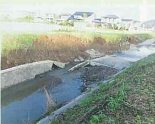
胡桃川護岸崩落
