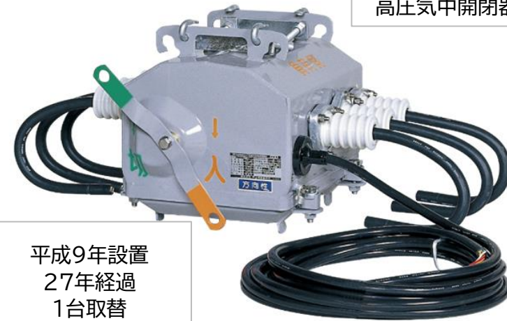
高圧気中開閉器詳細
